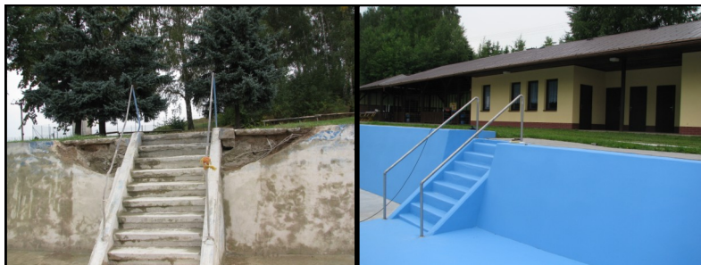
Jaro 2009 - stav před opravou
