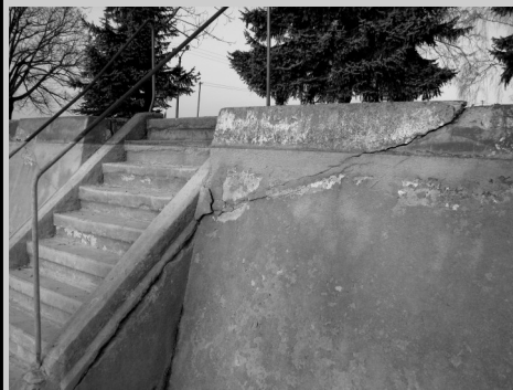
Utržené bloky jsou jedním ze závažných defektů, které by bez rychlé opravy způsobily zkázu nádrže
